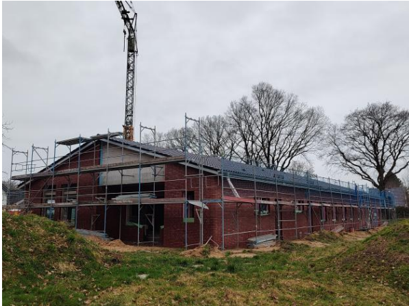
Der Bau des Ärztehauses in Wrist ist schon weit vorangeschritten. Foto: Christian Lipovsek
