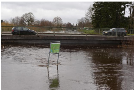
Die Bramau führt in Wrist so viel Wasser, dass sie bis an die Unterkante der Brücke in der Bokeler Straße reicht. Foto: Jann Roofls
